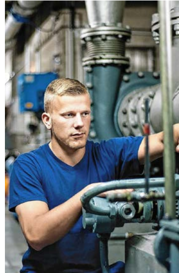
Alles in Ordnung? Ein Anlagenmechaniker der Berliner Wasserbetriebe überwacht die Pumpentechnik.
